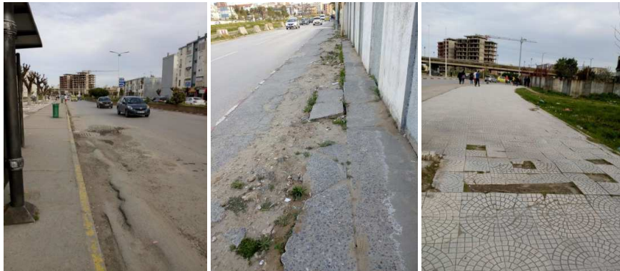
Fig. 5, 6 et 7. Des malfaçons dans la réalisation de la chaussée et ses accessoires (Auteur, 2018 et 2019)
